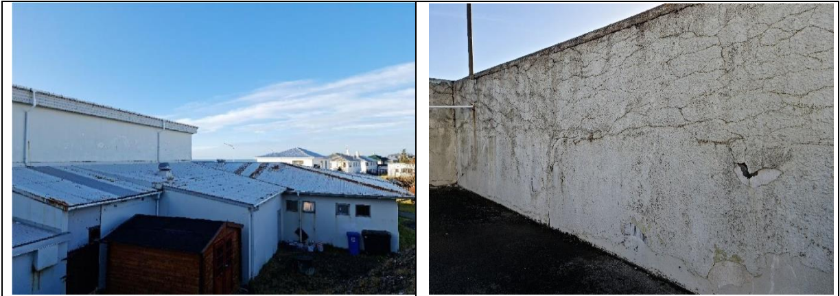
Myndir. Endurnýja þarf þakklæðningu norðanmegin. Skjólveggur við pottasvæði er illa farinn.
